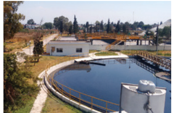
Sistema de tratamiento de agua de post-consumo
